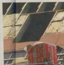
Bepik warmteverlies via het dak. Foto: Kees
